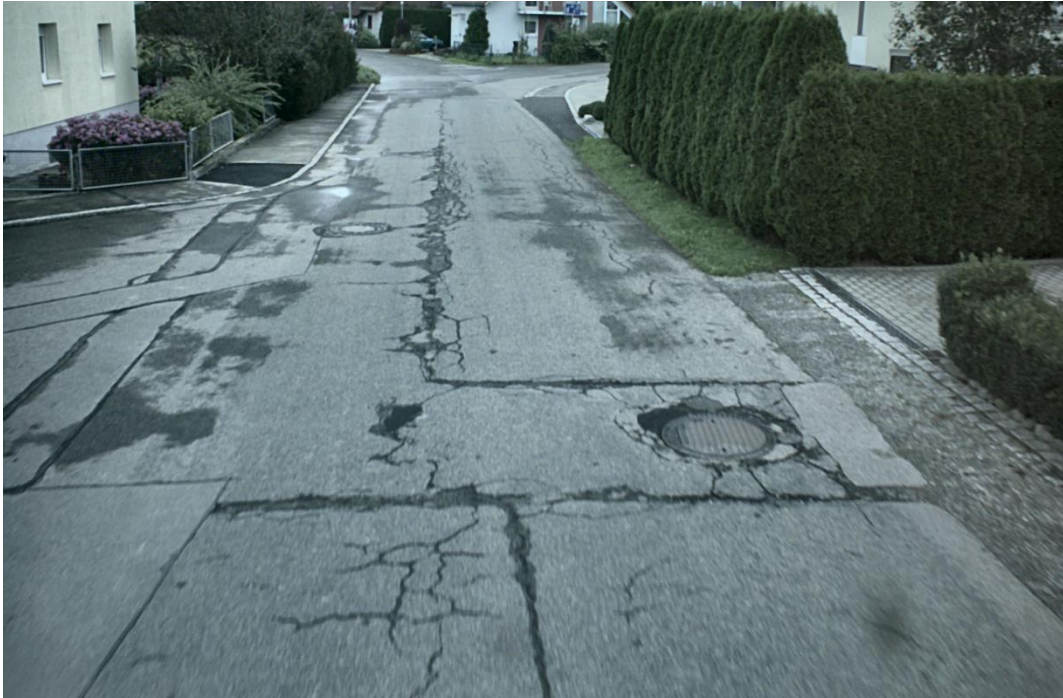
Booser Straße (Setzungen, Risse, Flicke)
