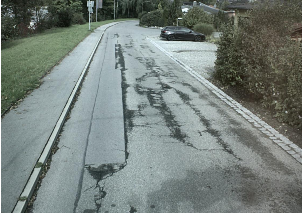
Sättelstraße (Setzungen, Risse, Flicke, Ausbruch)
