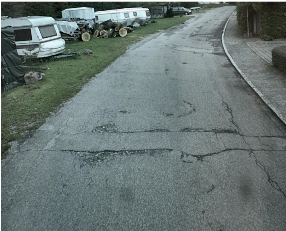
Reutener Straße (Risse, Setzungen, Ausbruch)
