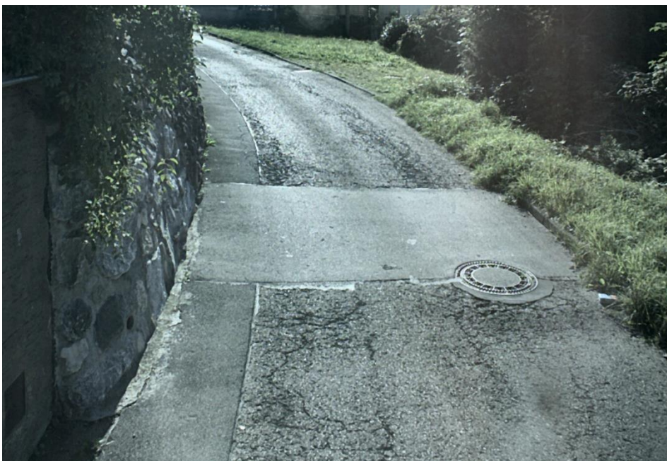
Gumpenweihergäble (Setzungen, Risse, Flicke)
