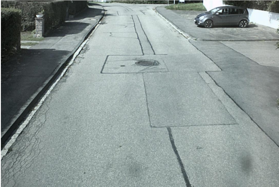
Hillstraße (Risse, Setzungen)
