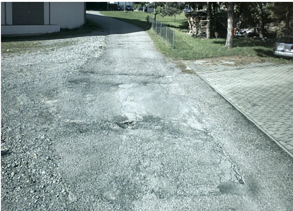
Zollenreuter Fußweg (Ausbruch, Risse, Flicke, Setzungen)
