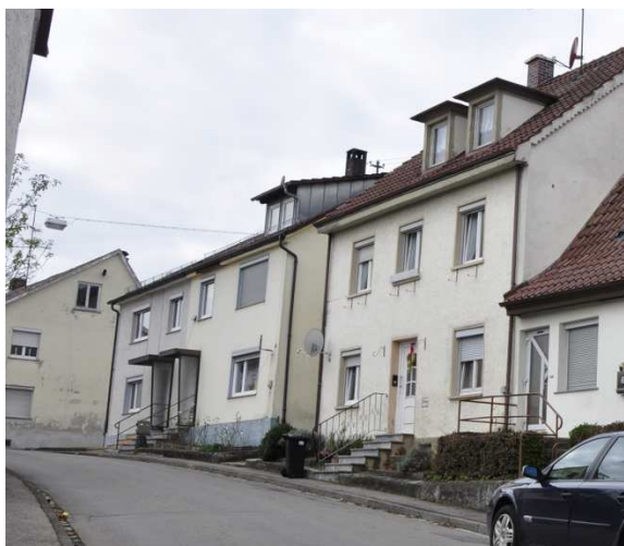
Außentreppen mit Sanierungsbedarf, Eckstraße
