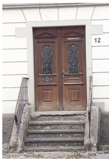
historische Tür mit Sanierungsbedarf Zollenreuter Straße 12
