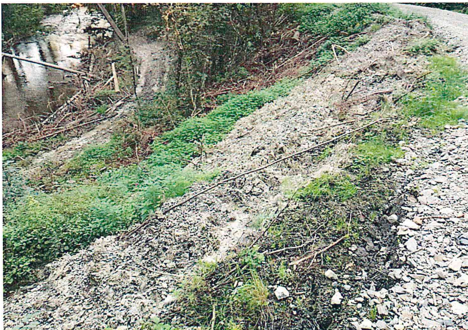
Bild 3. gerutschte talseitige Böschung:
