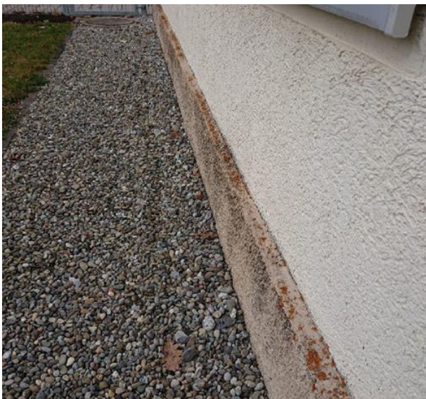
Bilder B1.3: Kiga Sockelbereich Mikrobenbewuchs
