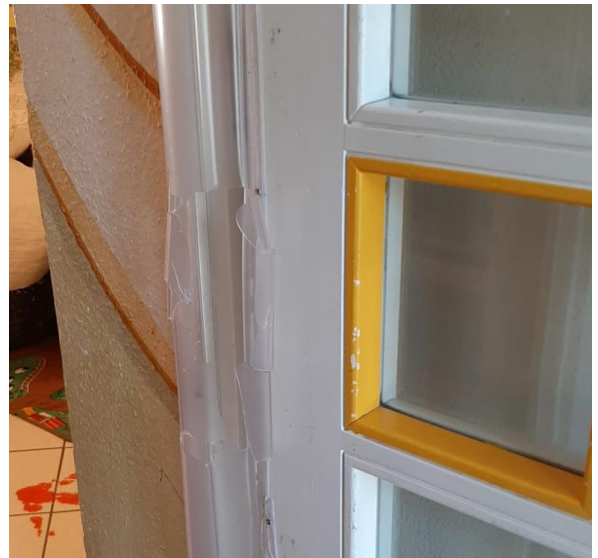
Bild B4: Klemmschutz an den Türen ist defekt.
