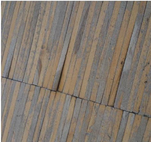
Bilder B2: Parkett Fugen- und Versiegelungsschäden im EG
