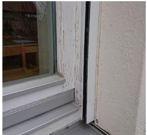
Bilder B1.4: Kiga Holzfenster Anstrichschäden
