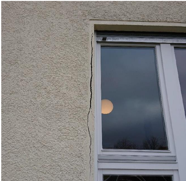
Bild B1.1: Kiga Mauerwerksriss in der Fensterleibung
