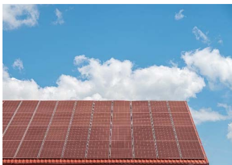
Farbige PV-Module Aufdach-Installation
