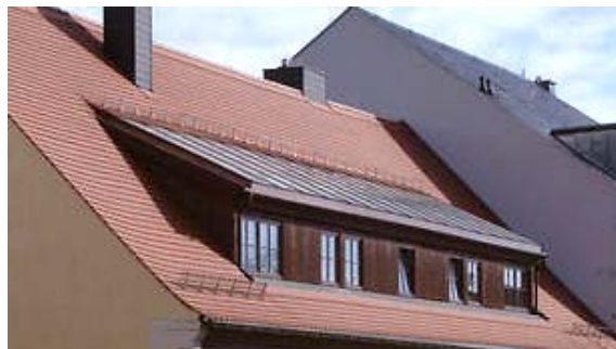
Solaranlage auf Schleppgaube (Foto: Soli fer Solardach GmbH)
