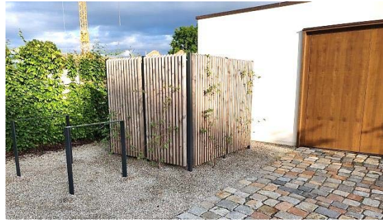
Luftwärmepumpe , außen, eingehaust, Bsp. Wangen
