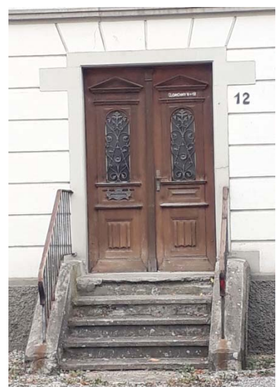
historische Tür mit Sanierungsbedarf Zollenreuter Straße 12
