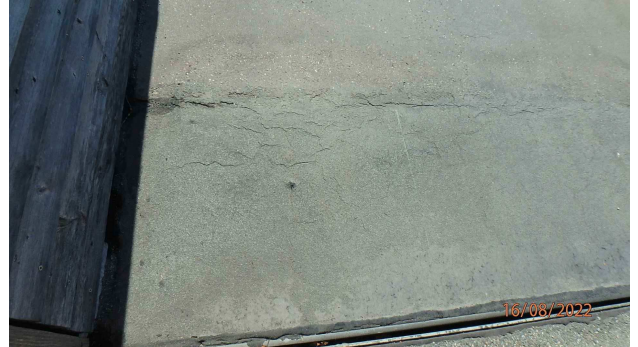
2022E_SCHADEN_16_BELAG WELLIG UND RISSIG
